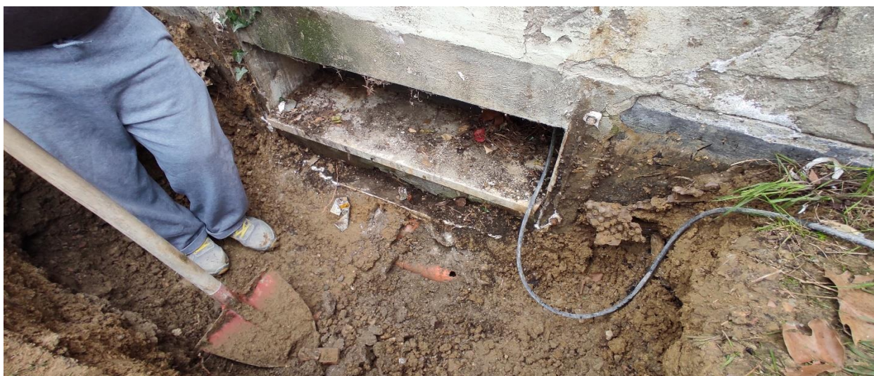
Foto - Tubazione in PVC interferente
