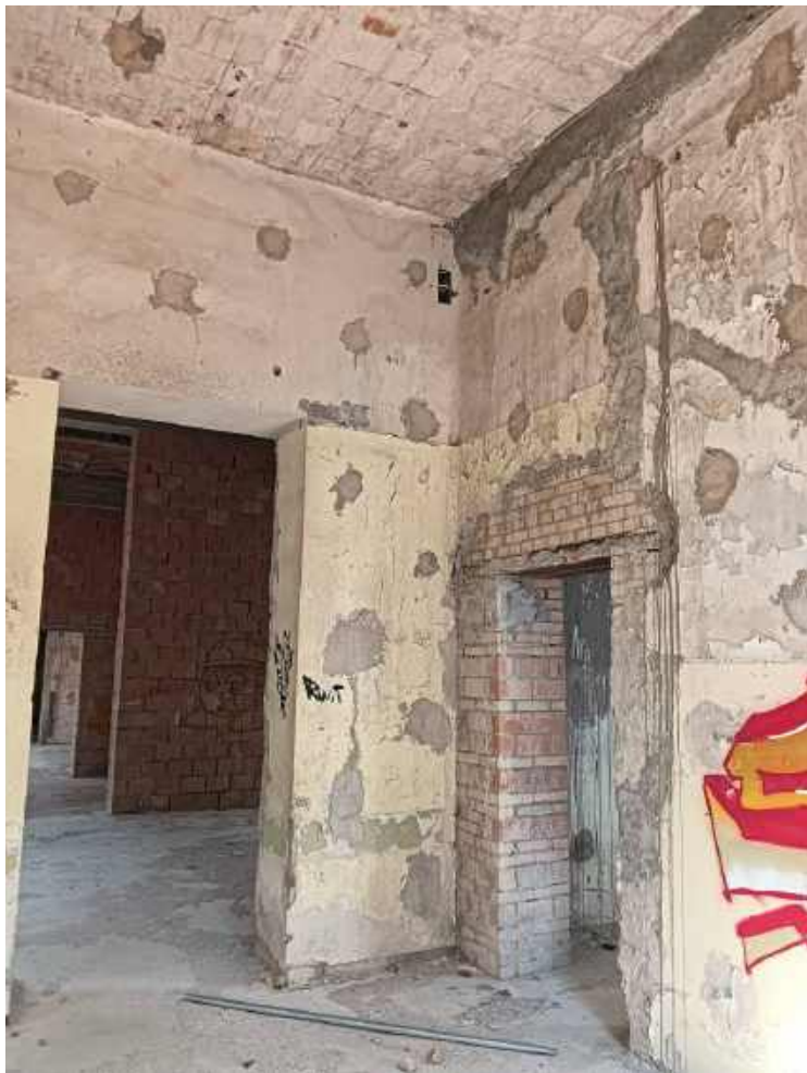
Foto n. P0-22c
