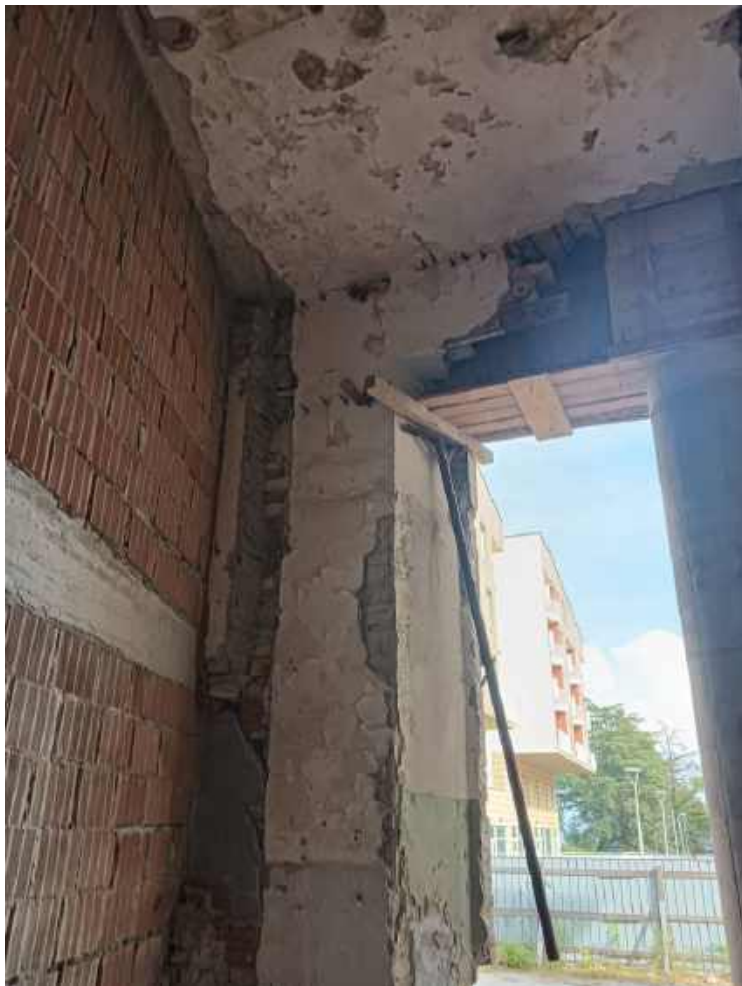
Foto n. P0-13c
