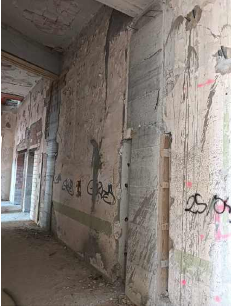
Foto n. P0-7c
