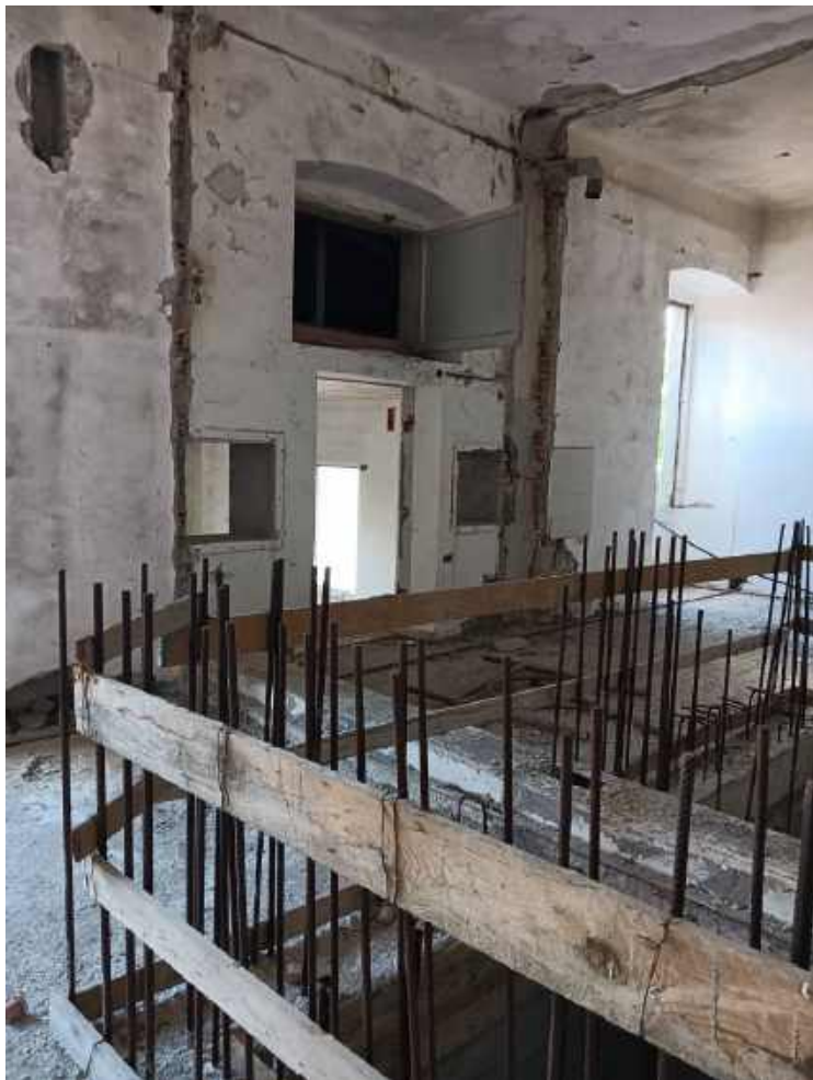
Foto n. P2-4c
